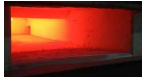
Muestra C: Revestimiento nuevo del horno
